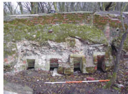
Abortschächte in der eingestürzten Decke des Sammelbeckens
